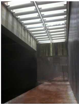
图 6-1 排风亭降噪处理
