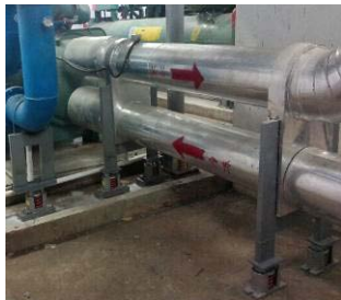
图 7 管道支撑隔振
